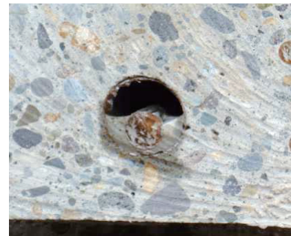
写真-1 グラウト未充填
