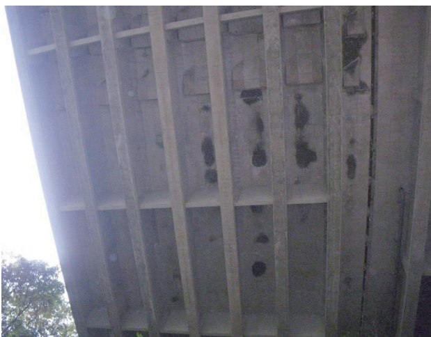
写真-1 合成桁橋床版の劣化状況例
