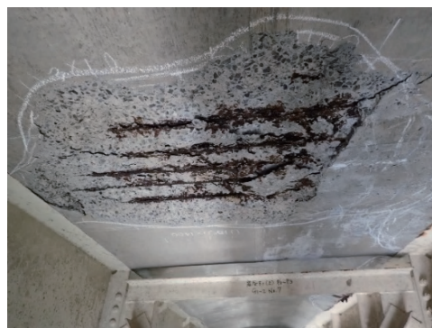
写真-1 床版下面の劣化状況
