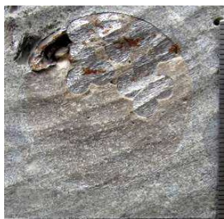
わずかな隙間（C5 近景）
