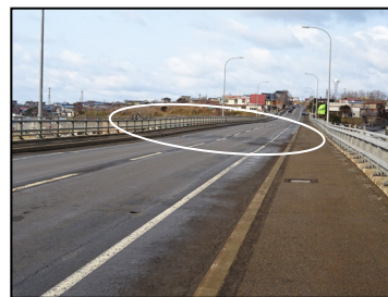
写真-2 ヒンジ部路面の状況
