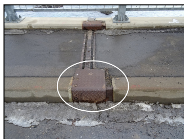
写真-4 鋼製カバーの破損
