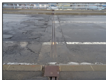
写真-3 舗装損傷と滞水状況
