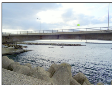
写真-1 ヒンジ部の状況
