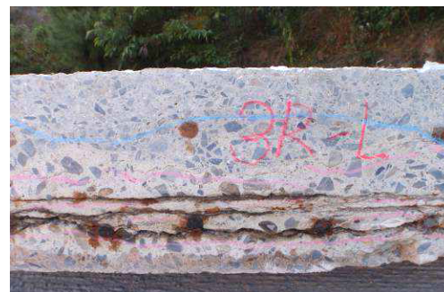
写真—5 床版断面ひび割れ
