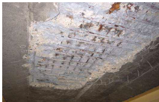
写真—4 既設床版下面損傷状況
