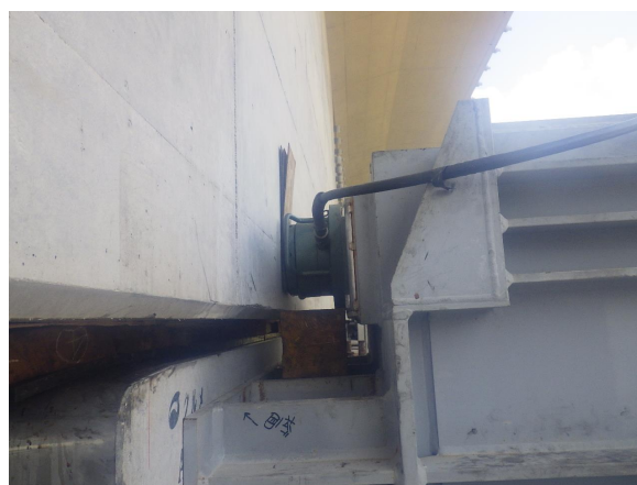
写真-4 横方向制御装置
