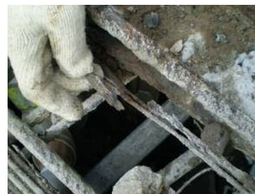
写真-2 B橋PC鋼材破断状況
