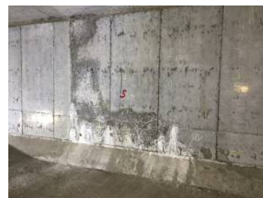
写真-1 A橋箱桁内の水しみ状況
