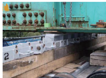
写真－7 横取り装置
