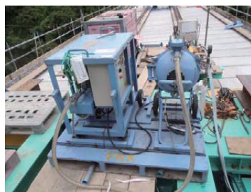
写真－10 真空ポンプ
