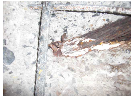
写真－2 主ケーブルの腐食・破断
