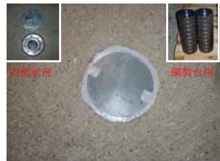
写真-2 既設リフトアップ金具(表面)
