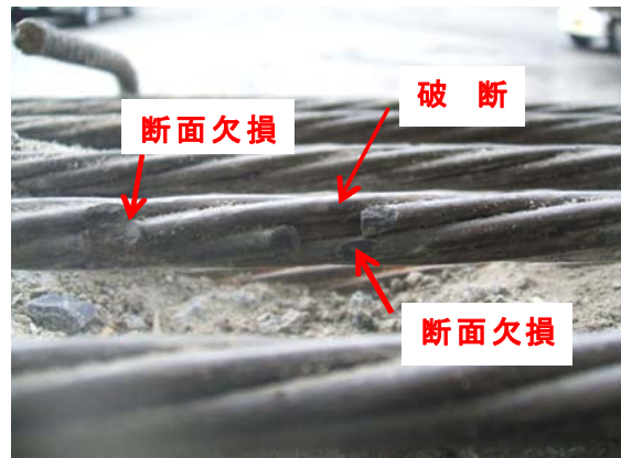
写真-2 PC 鋼より線の破断状態
