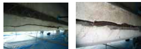
写真-2 PC桁の劣化状況
