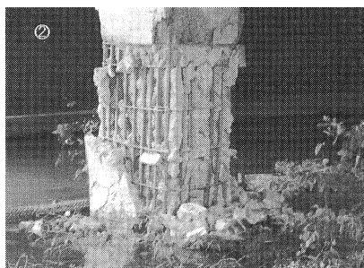
写真-11 橋脚のせん断破壊
