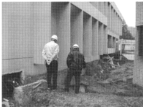
写真-7 地盤の流動
