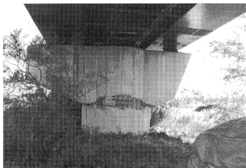
写真-8 橋脚の損傷（小千谷大橋）
