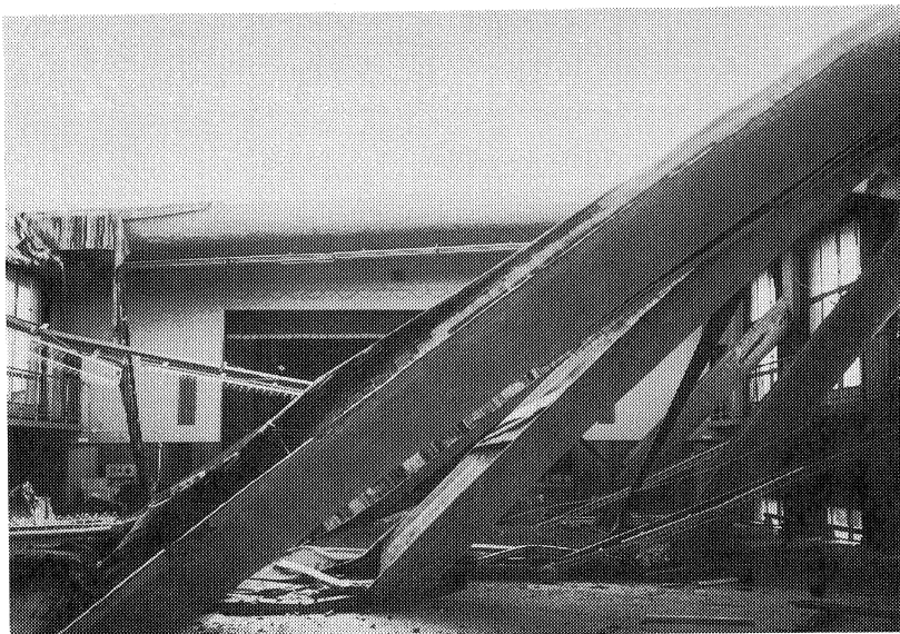
写真-7 西宮市立甲東小学校体育館 プレキャストU形PC屋根版
