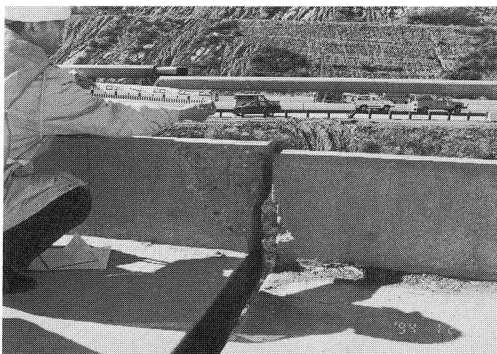
写真-20 ゲルバーヒンジ部のジョイントに生じた 大きな目開き（落橋寸前）
