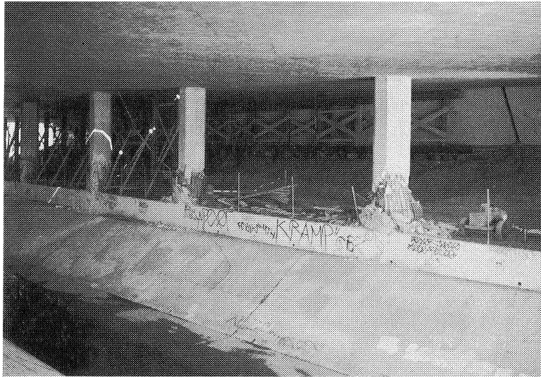
写真-8 地盤面位置で破壊したP3橋脚 (S-118 ブルクリーク橋)
