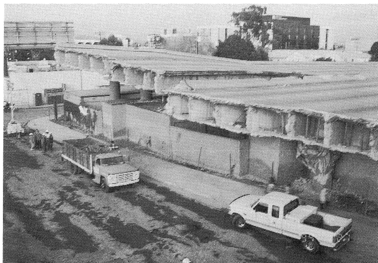
写真-12 サンタモニカフリーウェイ (I-10) のラシェネガ・ベニス地区の橋梁被害 (手前は、すでに撤去されている)
