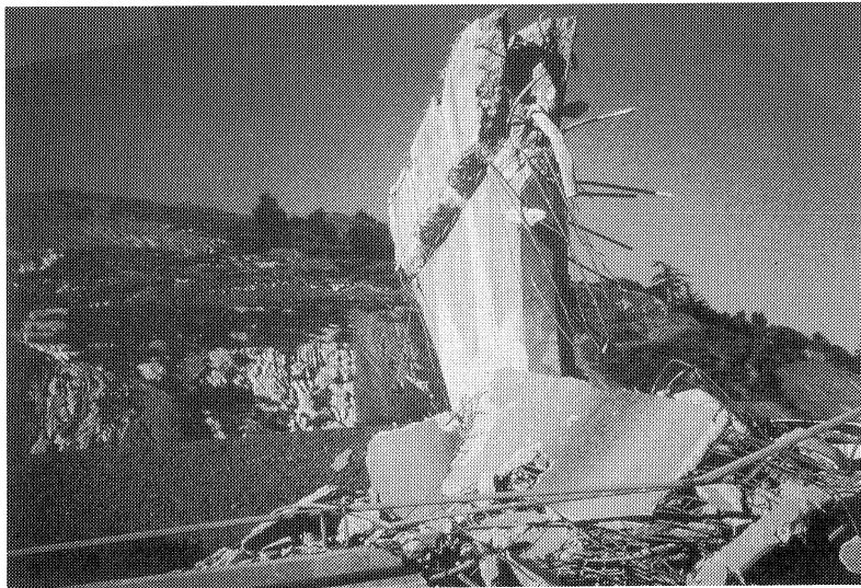
写真-17 壊れ残ったP3橋脚とキャップビーム （カリフォルニア大学バークレイ校による）
