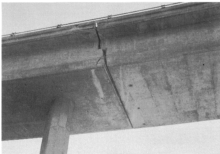
写真-19 桁掛り長が非常に短く，残留移動によって 落橋寸前のゲルバーヒンジ部
